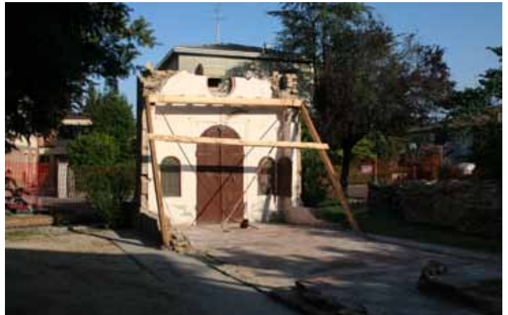
L'oratoire après les relevés, la fouille des parties écroulées et mise en sécurité de la façade, travaux réalisés par des bénévoles guidés par des archéologues.
